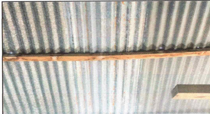
Foto1: La costaneras se encuentran en estado de pudricion debido a las goteras con las que cuenta la lámina.
