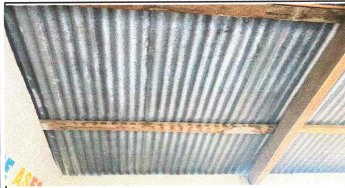
Foto 3: las vigas y costaneras del techo del modulo, estan podridas, esto hace que el techo se vurve a un punto de colapsar y corre el riesgo de caer sobre los niños en cualquier momento.
